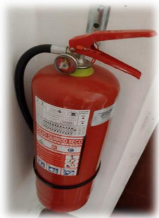
Imagen 4: Extintor PQS 10 kgs. eléctrico.
